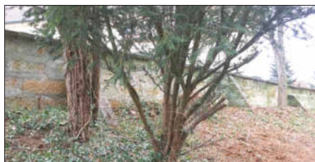
Ansicht der gefährdeten Burker Friedhofsmauer
