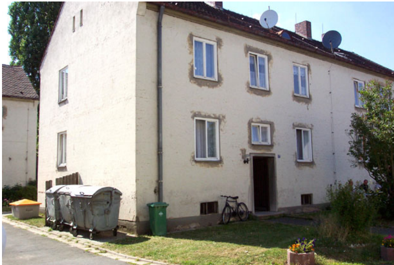
Unschöne Müllbeseitigung und schadhafte Fassade (Foto Ebe)
